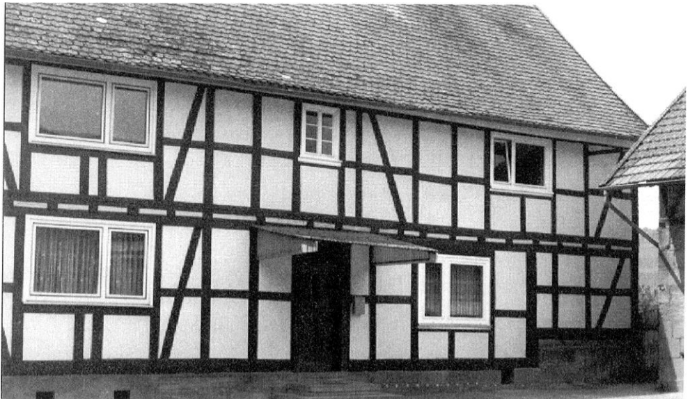
Einem Brand im Jahre 1945 fielen der Dachstuhl des Hauses sowie die Wirtschaftsgebäude zum Opfer. Im Jahre 1975 wurden der Heu- und Strohboden sowie der Dachstuhl der Scheune erneut von einem Brand vernichtet.
